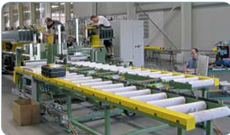
Inbetriebnahme einer Fertigungslinie für Sektionaltore
